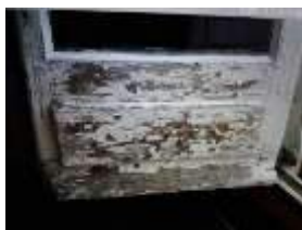
Une fenêtre d'un logement de gendarme en mauvais état (Crédit photo:DR).
