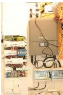
L'onduleur grâce auquel l'énergie captée alimente le réseau domestique Crédit photo IGC
